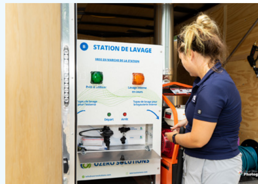
Station de lavage d'embarcations nautiques.
